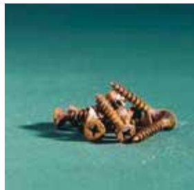
Abbildung 5.2 Grundmetallkorrosion (Rotrost) an galvanisch verzinkten Schrauben
